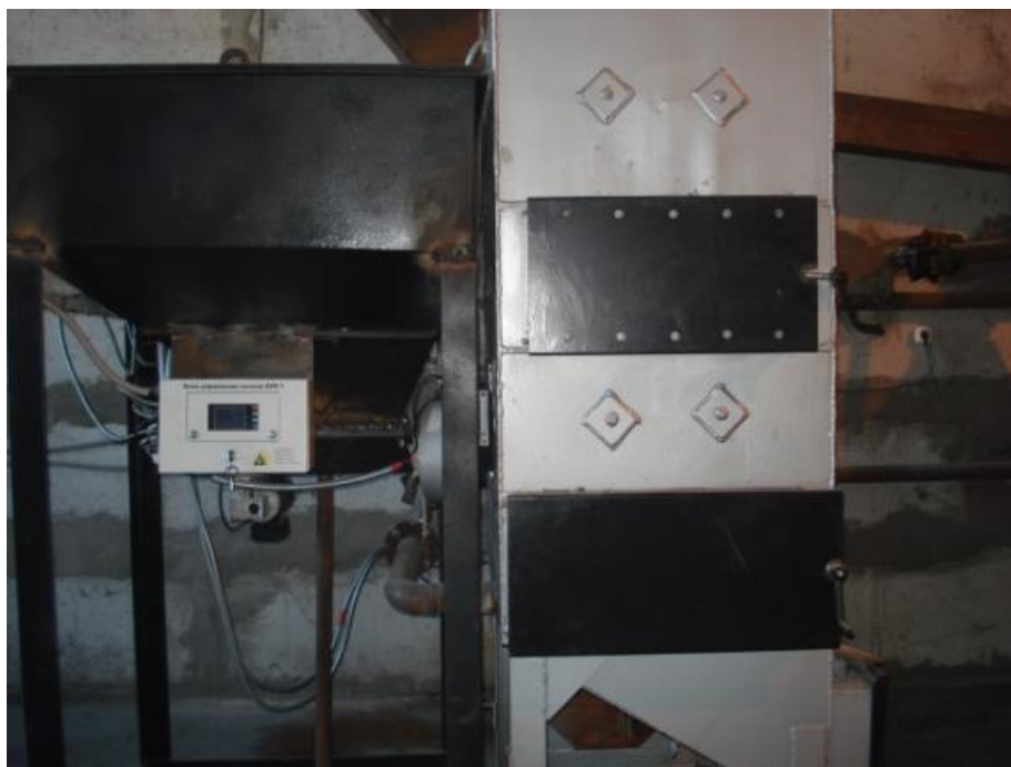
Рисунок 1 - Внешний вид котла со шнековой подачи на 300 кВт. Установлен на ТОО «Рапид»
